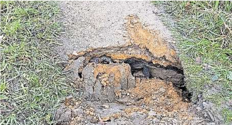
Der jüngste Schaden im Kreis Viersen war auf einem Wanderweg westlich des Breyeller Sees: Der Weg war durch einen Nutria-Gang eingebrochen.
